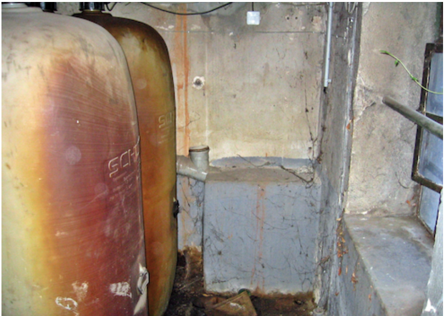
Verfärbungen und Materialermüdung bei einem Kunststofftank
